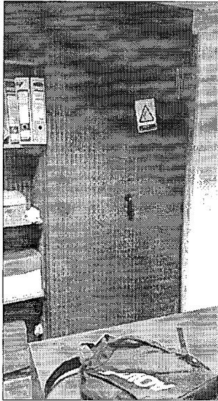
09. SUBSUELO (Tablero Seccional)
