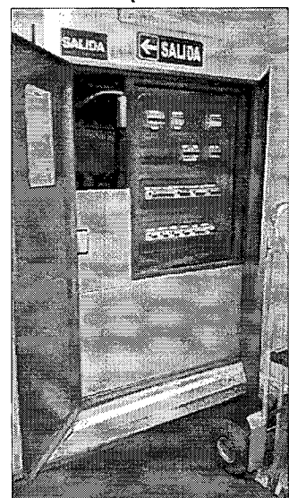
16. PLANTA BAJA (Tablero Seccional)
